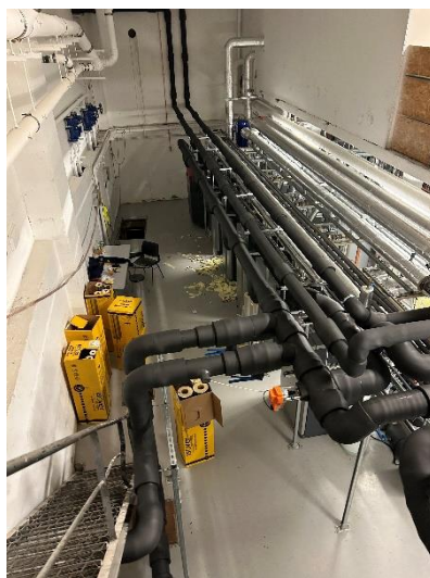
Den nye energisentralen i Københavngata 10
